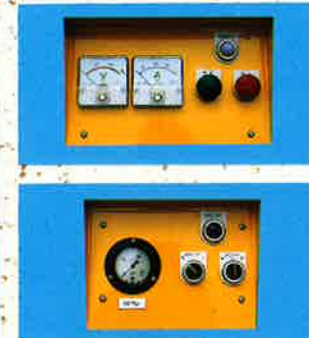
5. 操作盤(操作部)
